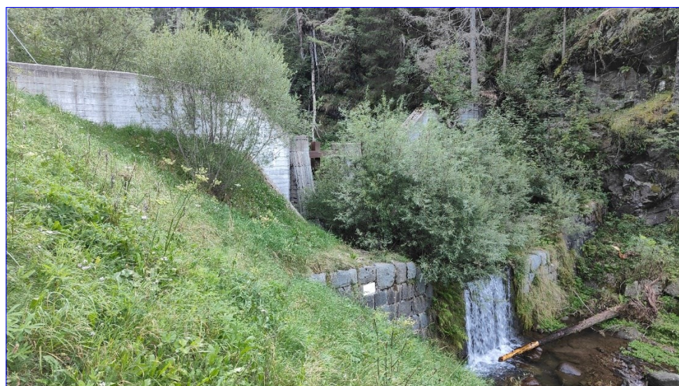
Foto 9: briglia filtrante posta a monte dell'abitato di Lenzi.
