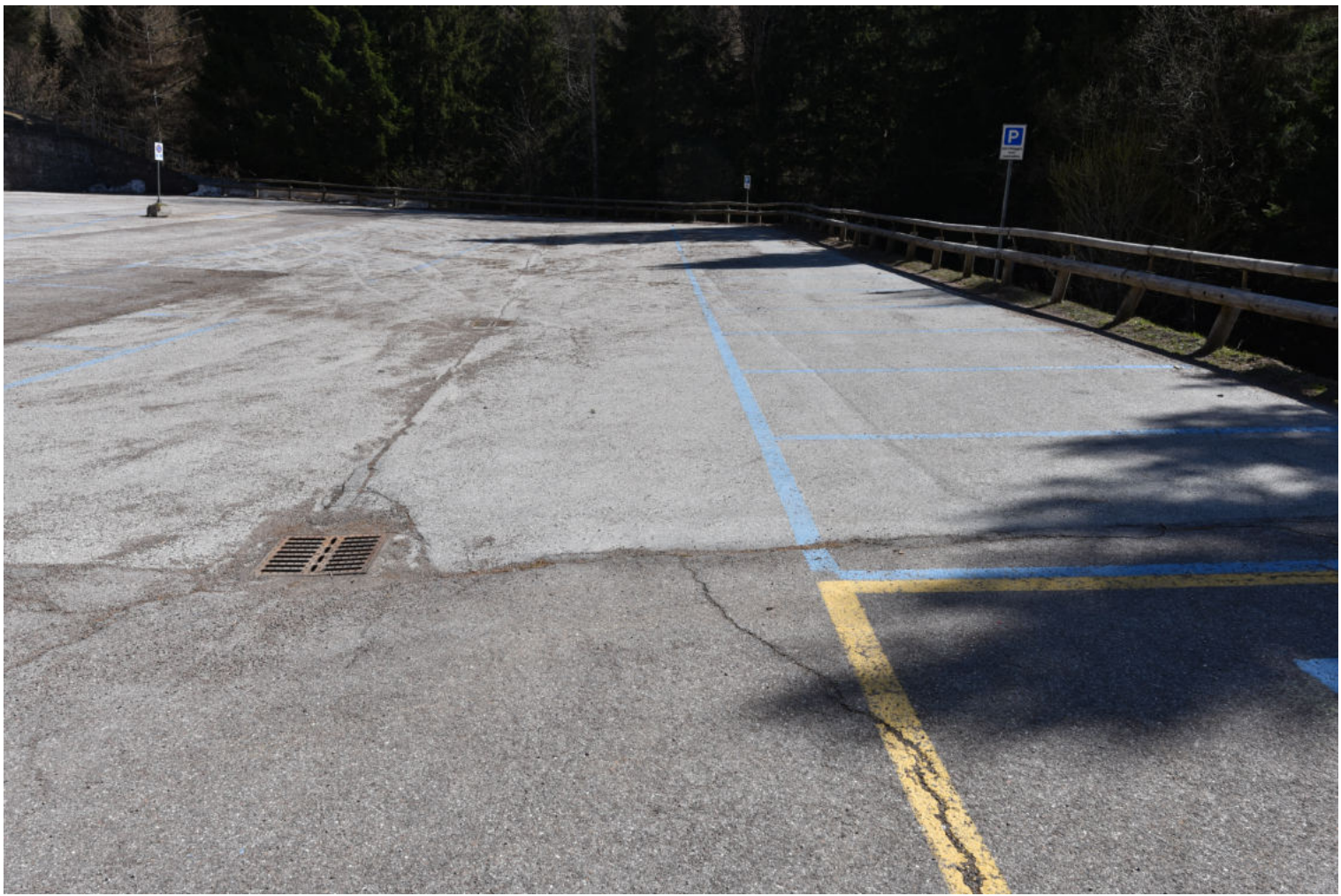
foto 4 - caditoie esistenti nel piazzale per lo smaltimento delle acque meteoriche
