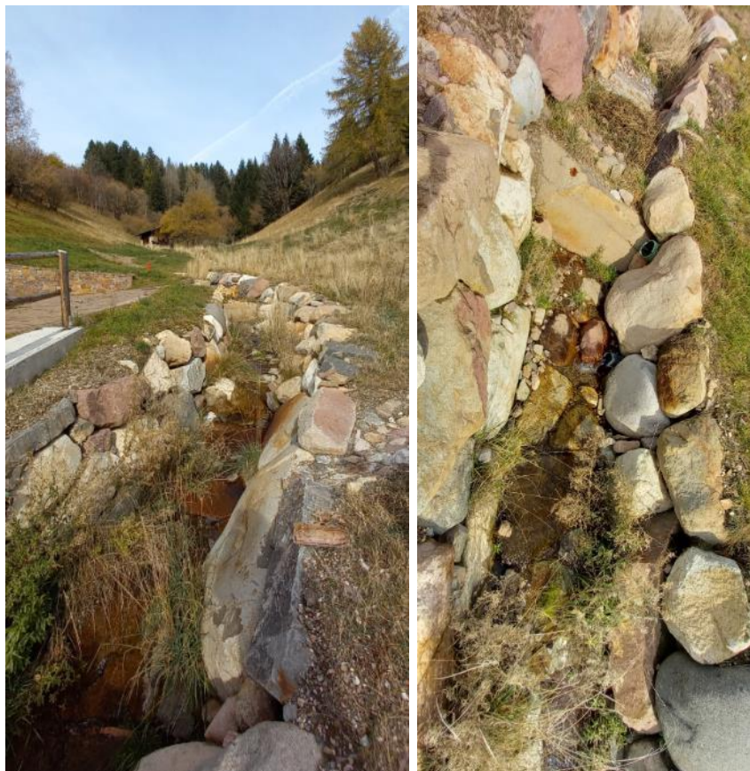
Figura 4.11: F10 – Vista della sistemazione apicale del rio a valle con la presenza di diversi drenaggi del terreno (bacino giallo).
